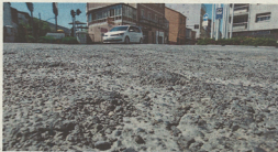
Estado del firme a la altura del paso a nivel de A Florida. ALBERTO LÓPEZ
