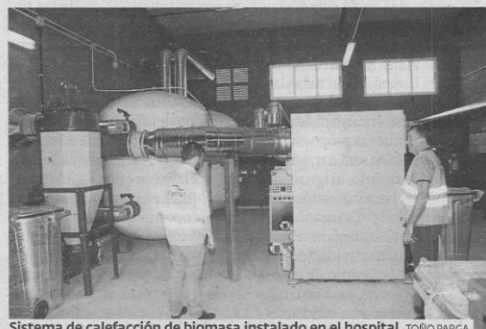
Sistema de calefacción de biomasa instalado en el hospital. TOÑO PARCA
