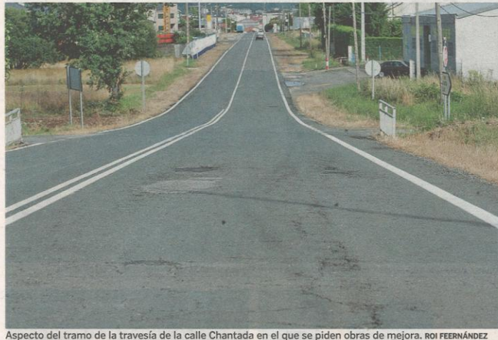
Aspecto del tramo de la travesía de la calle Chantada en el que se piden obras de mejora. ROI FEERNÁNDEZ
